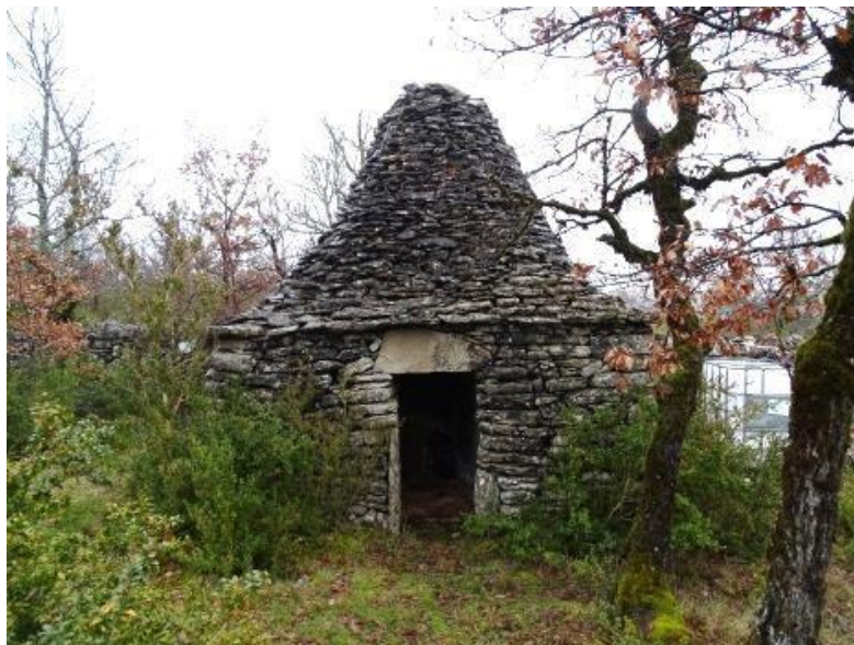
Toiture en lauzes calcaires dégradée
